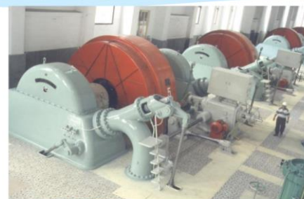
大觀發電廠Pelton Water Turbine
