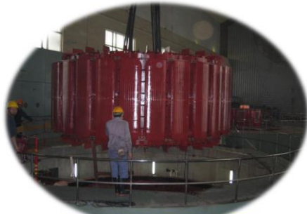
德基發電廠 發電機轉子
